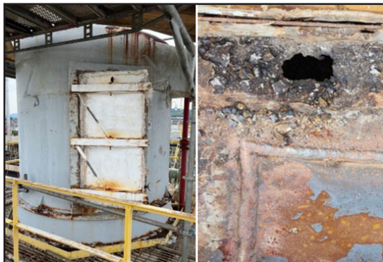
Structure de chambre à filtres avec une brèche corrodée.
